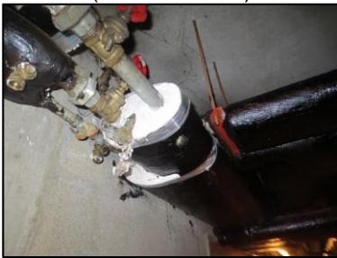
Photo N° 927 ECH-N°1 CALORIFUGEAGE --COULOIRS DE CAVES Conduits de fluide Laine minérale + enveloppe bituminée
