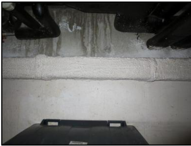
Photo N° 922 AMIANTE CIMENT -- LOCAL VO -1 Gaines & coffres horizontaux Ventilation haute (Fibres-ciment)
