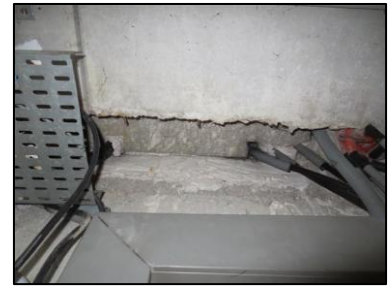
Photo N° 926 AMIANTE CIMENT -- PLACARDS TECH -1 à +4 Plafonds Plaques planes (Fibres-ciment)
